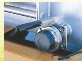
Vanne sur grille d'égouttage
